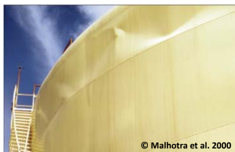
Stabilitätsversagen in Form von Manteldruckbeulen bei einem flüssigkeitsgefüllten Tank © Malhotra et al. 2000
